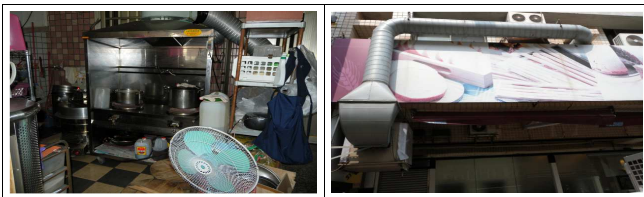
圖 10 排油煙風管設備
