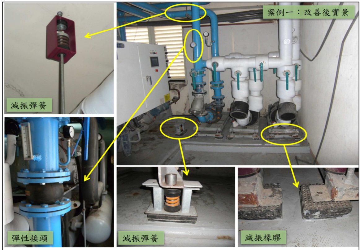
圖 23 機房噪音改善方式
