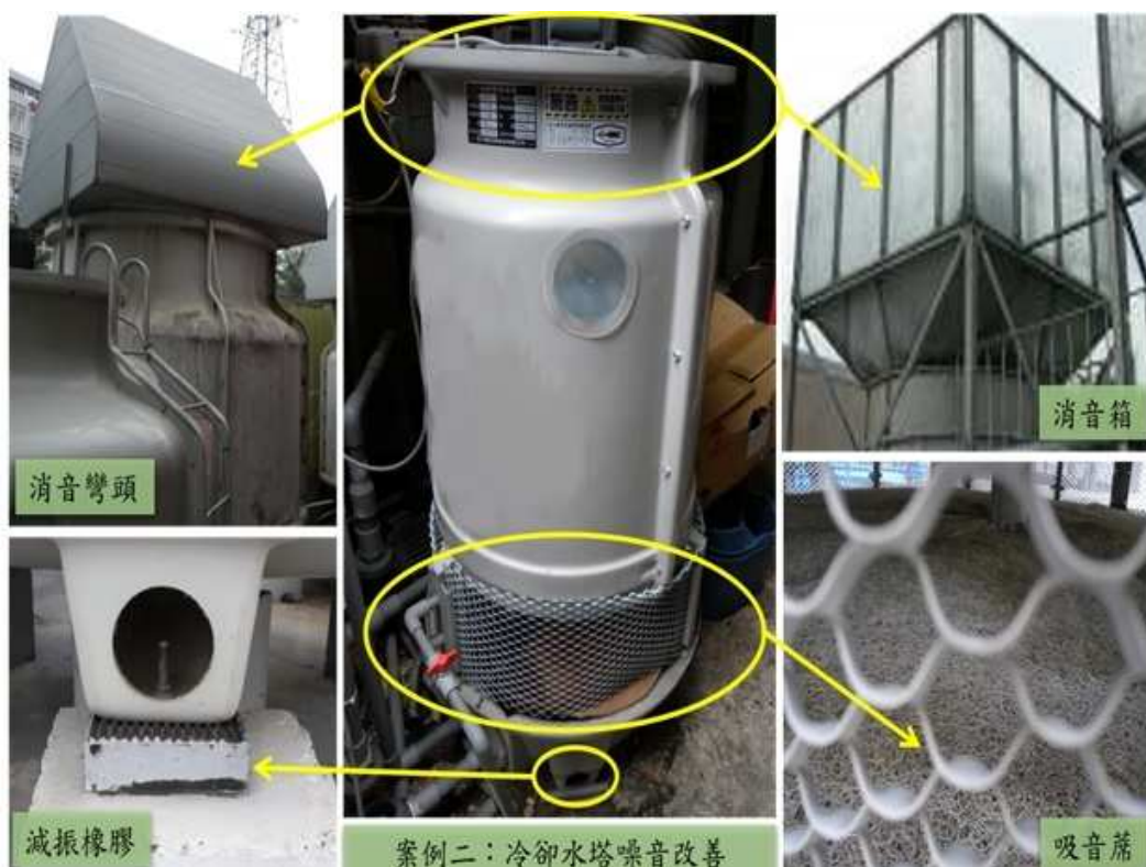
圖 18 冷卻水塔改善方式
